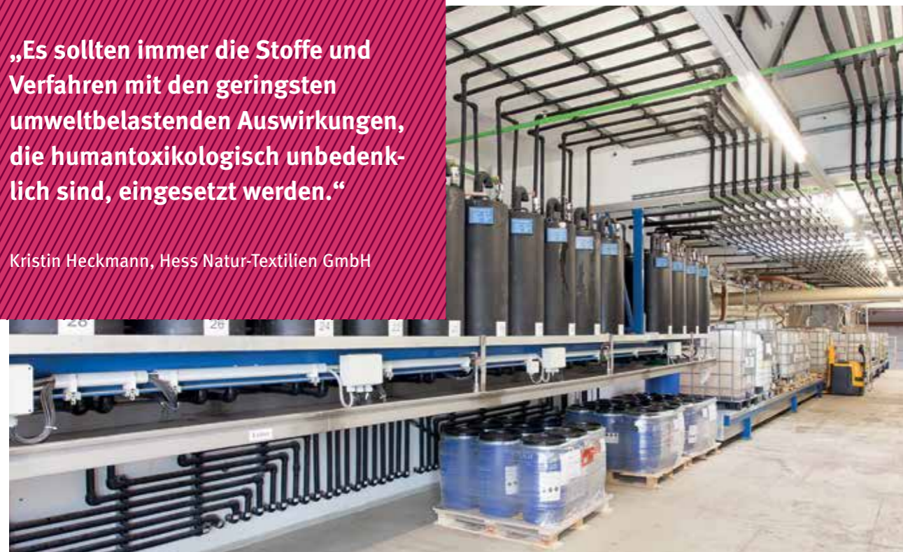
Technisch optimal gelöster Transport von der Chemikalienlagerung zu den Ansatzbehältern. Von dort führen dann Leitungen direkt ins Chassis.
